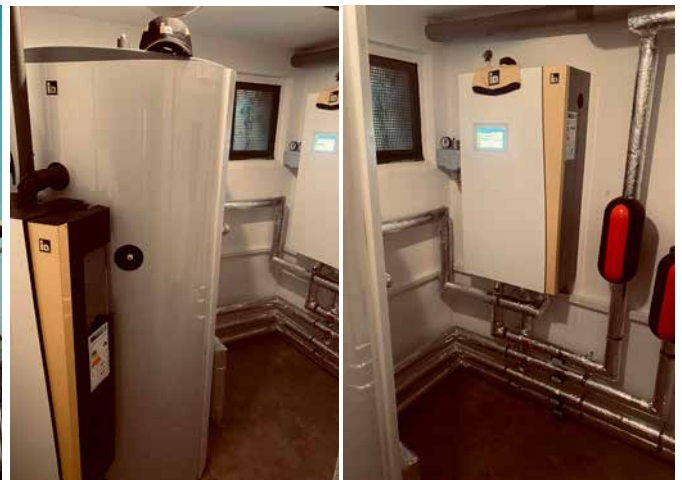
Im Einfamilienhaus wurde im Zuge der Heizungssanierung die 52 Jahre alte Ölheizung gegen eine nachhaltige iDM Luftwärmepumpe AERO ALM 6-15 ausgetauscht.
