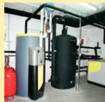
Heizen, Kühlen und Warmwasser aus einer Anlage.
