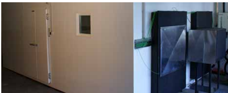
Die aktuelle Klimakammer hält die Temperaturen von -20°C bis +30°C auf 0,2 Kelvin konstant, die Luftfeuchtigkeit von 30-100% auf +/- 2%!
