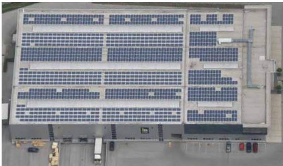
2.232 m 2 Bruttobezugsfläche für 329,04 kWp - damit ist die Photovoltaikanlage bei IDM eine der größten in Westösterreich, sie liefert Leistung in der Höhe des IDM-Stromanschlusswertes und rund 44% der im Jahreslauf konsumierten Energie.
