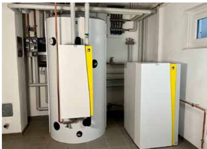
Auch diese Familie leistet mit dem neuen Heizsystem von iDM einen wertvollen Beitrag für unsere nachhaltige Zukunft.
