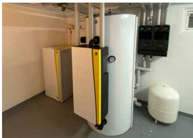
Die Familie ersetzt ihre alte Ölheizung durch eine innovative iDM Wärmepumpe.
